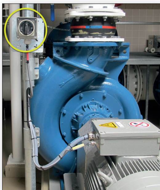
Afbeelding 1. Een werkschakelaar in de stroom bij de pompunit (geel omcirkeld).
